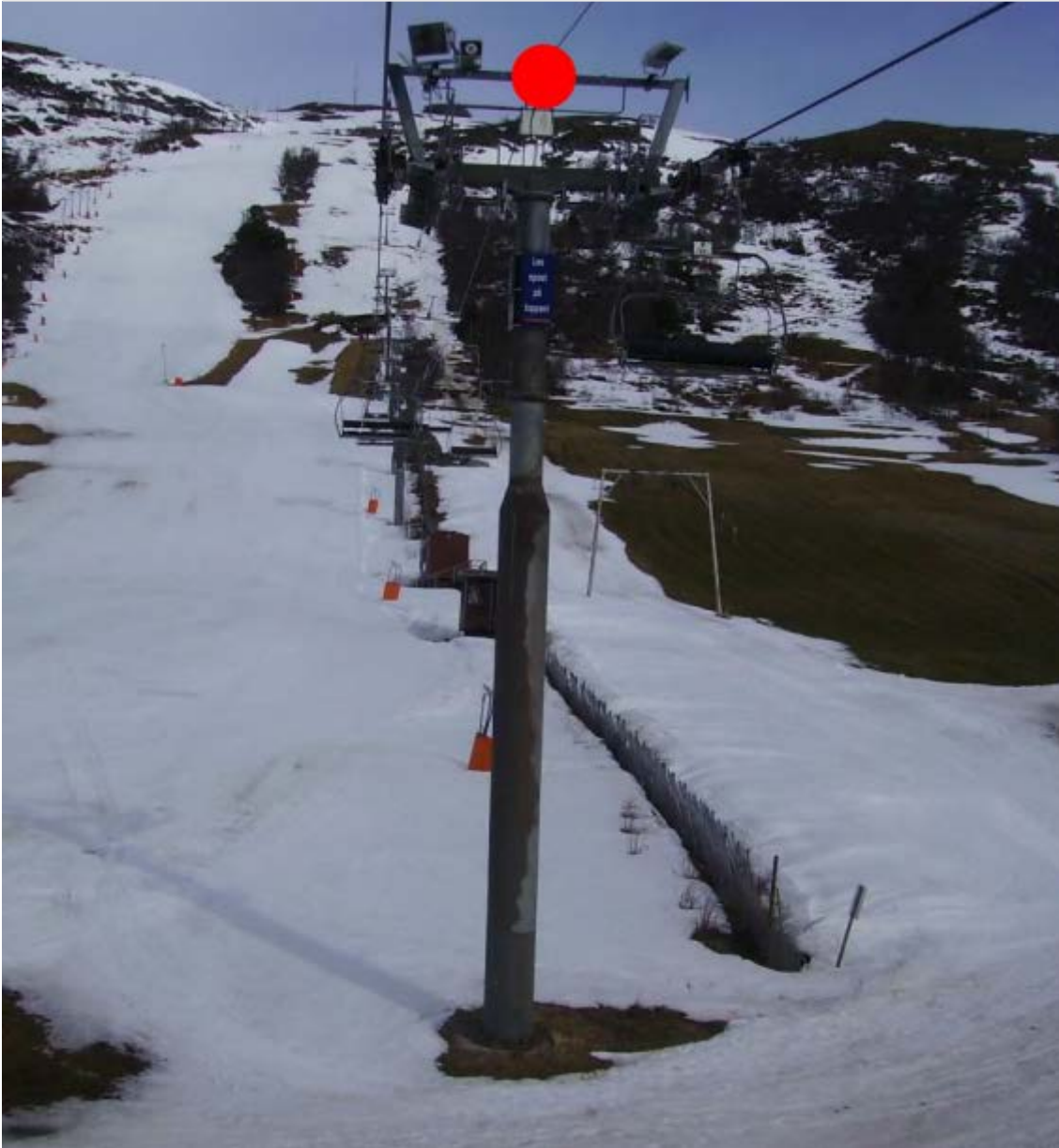
Figur 55. Eksempel på registrering av mast for stolheis
